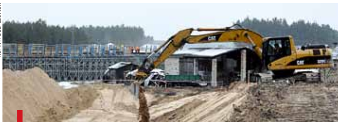
Kierowcy z ulgą przyjęli decyzję rządu, bo od lat czekają na oddanie całej S3. Na zdjęciu prace w okolicy Międzyrzecza
