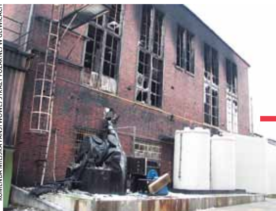
Zniszczona przez ogień hala przy ulicy Pszczyńskiej w Gliwicach
