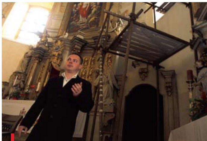
Państwo nie da milionów koron na ratowanie kościoła dla 25 osób. NA SĄSIEDNIEJ STRONIE: Księża często zostają opiekunami ruin, do których remontu zobowiązało się państwo
