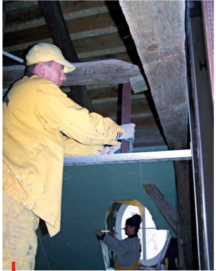
Na placu budowy praca wre. Inwestycja ma ruszyć już we wrześniu. Z BOKU: Billboard Charytatywnego Stowarzyszenia Niesienia Pomocy Chorym „Misericordia”
