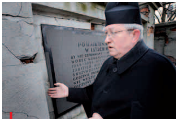
Proboszcz Józef Maj pokazuje powiększającą się szczelinę w murze
